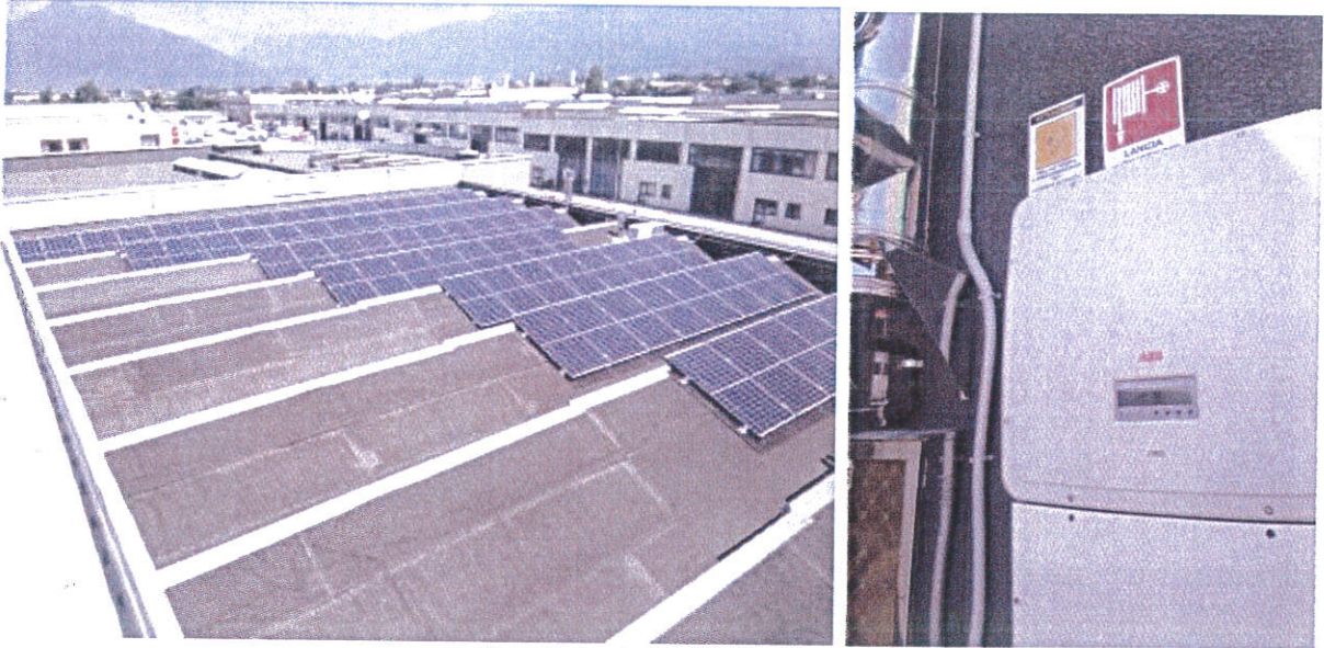
Figura 7 - Impianto FV 23,72 kWp
