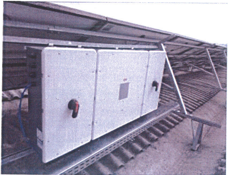
Figura 6 - Impianto FV 48,72 kWp
