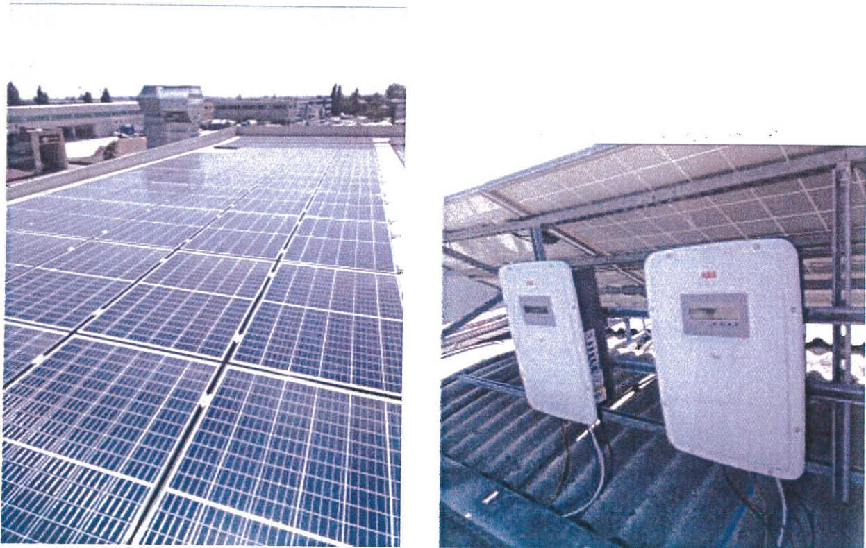
Figura 8 - Impianto FV 15,66 kWp
