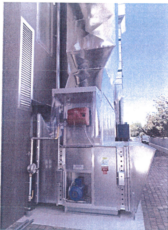
Figura 5 - Impianto di verniciatura realizzato
